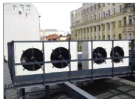
Заплановано впровадити теплові насоси відповідно до пропозиції компанії «ECOTHERMO»
