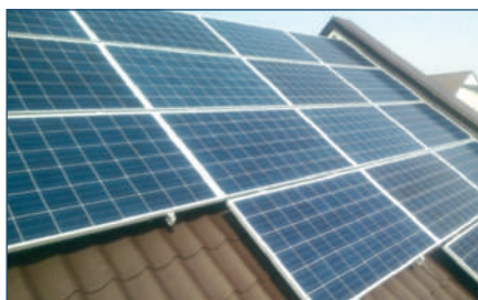
Приклад встановлення панелей сонячної електростанції (пропозиція ТОВ «Альтернатива»)
